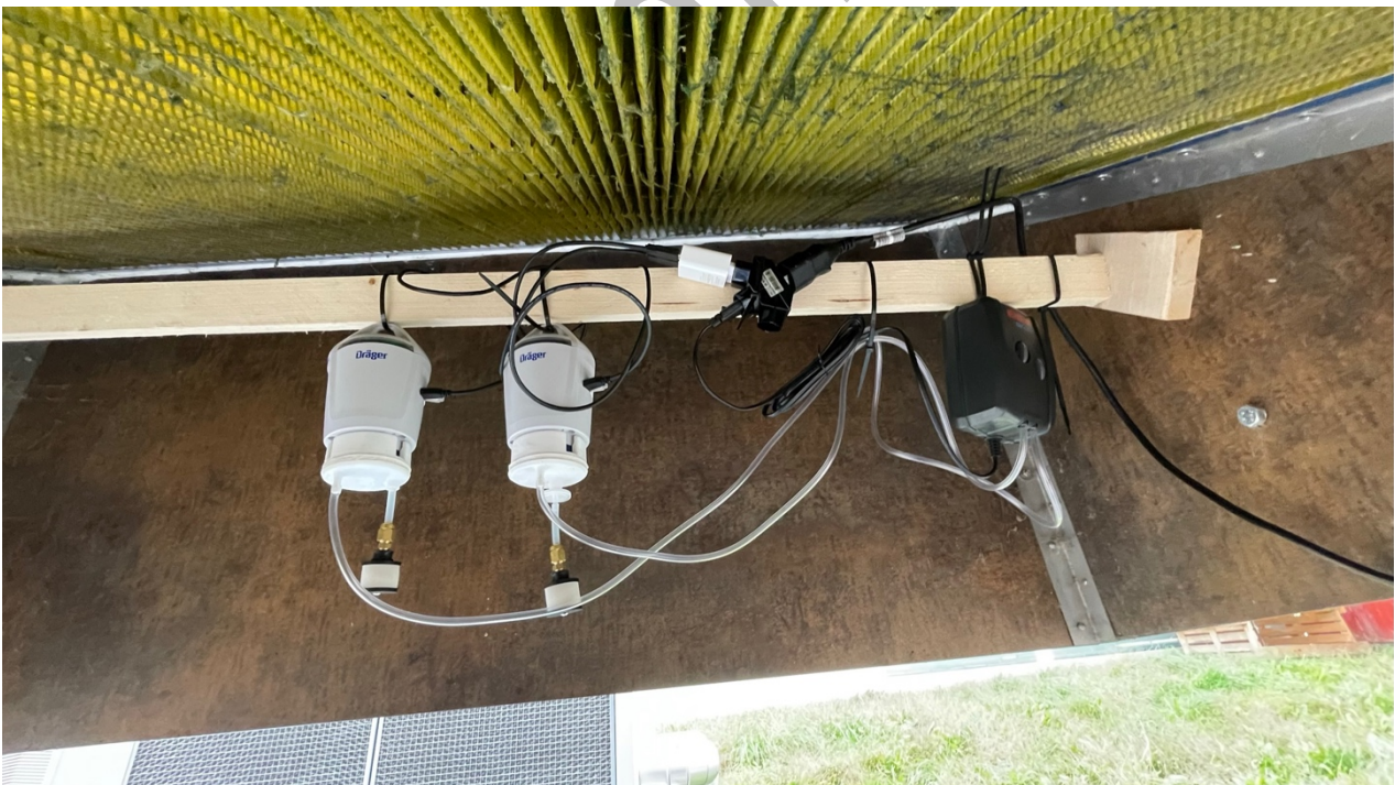
Abbildung 2: Sensoren (Dräger XNode) bei der Zuluft der WRG in Stall 2
